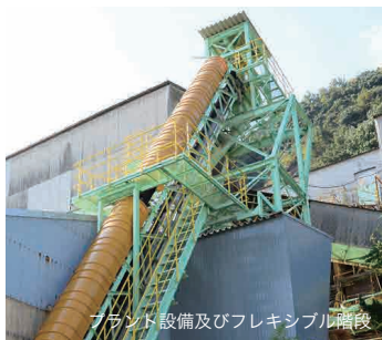
プラント設備及びフレキシブル階段
